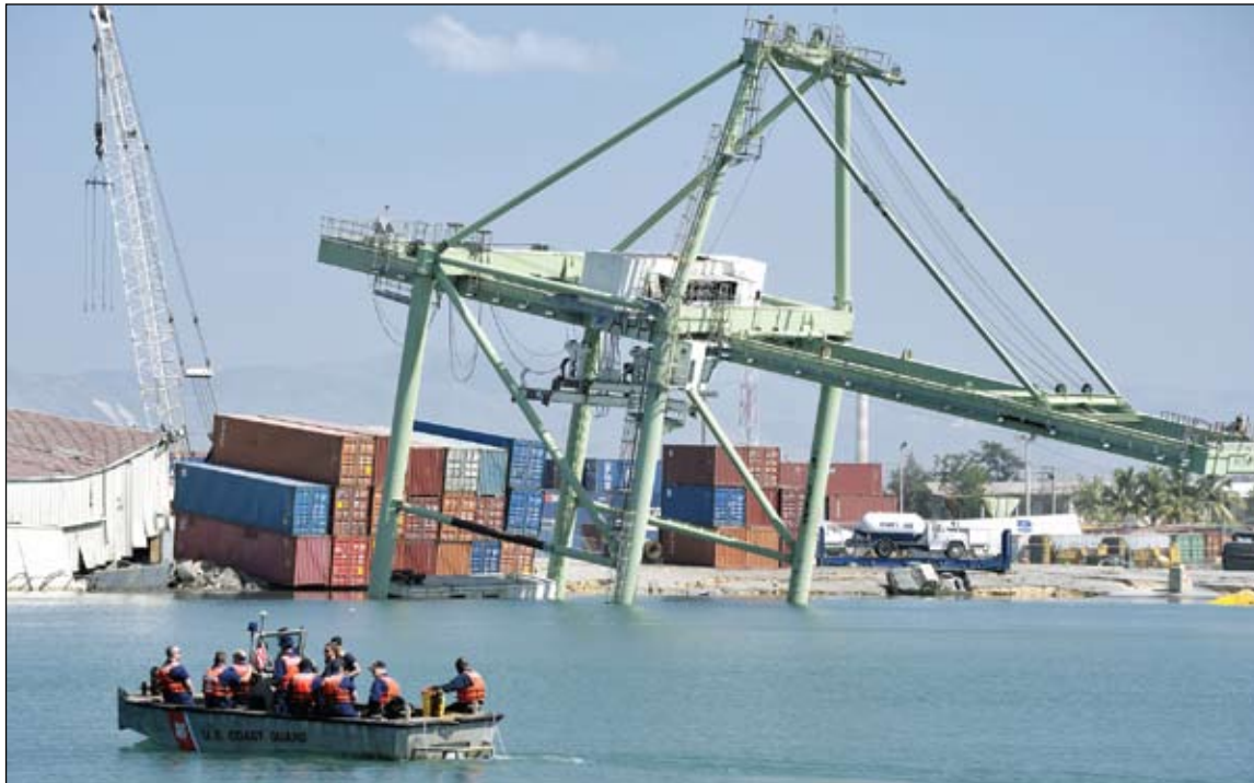
Les installations du port de Port-au-Prince n'ont pas été épargnées
